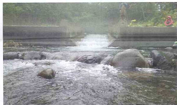
ウラハ川(北海道標津町)の堰堤に設置された提案魚道(プール式台形断面魚道)および多様な流れの創出を考慮した石組み(写真提供:安田陽一氏)
